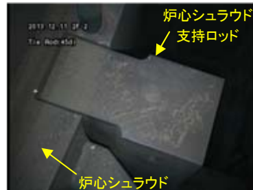
炉心シュラウド支持ロッド （平成25年12月11日撮影）
