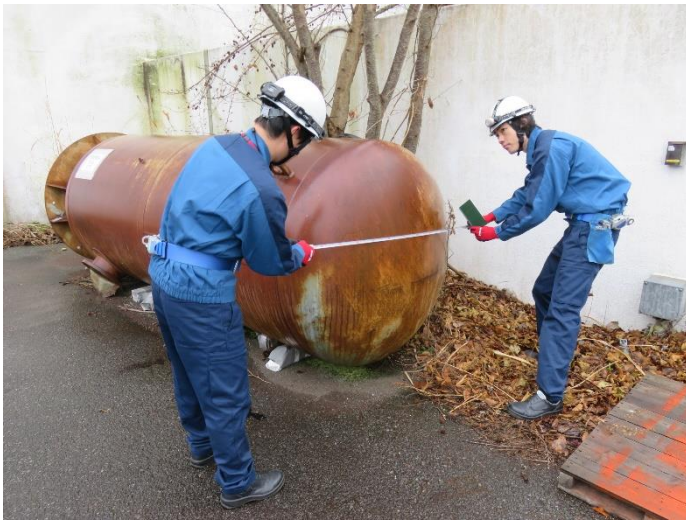
水処理建屋における竜巻影響評価のための 現場確認（飛来物の調査）
