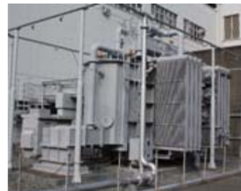
復旧後の起動変圧器
