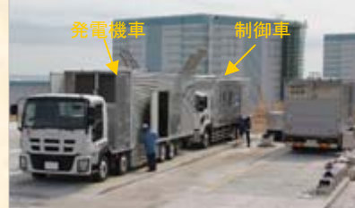
ガスタービン発電機車
