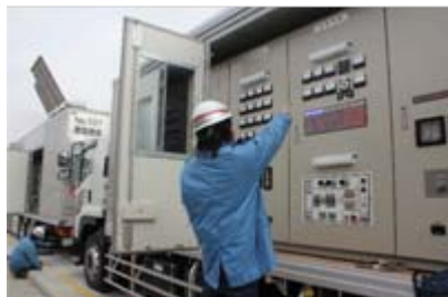
ガスタービン発電機車の起動操作
