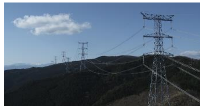
UHV交流送電線
