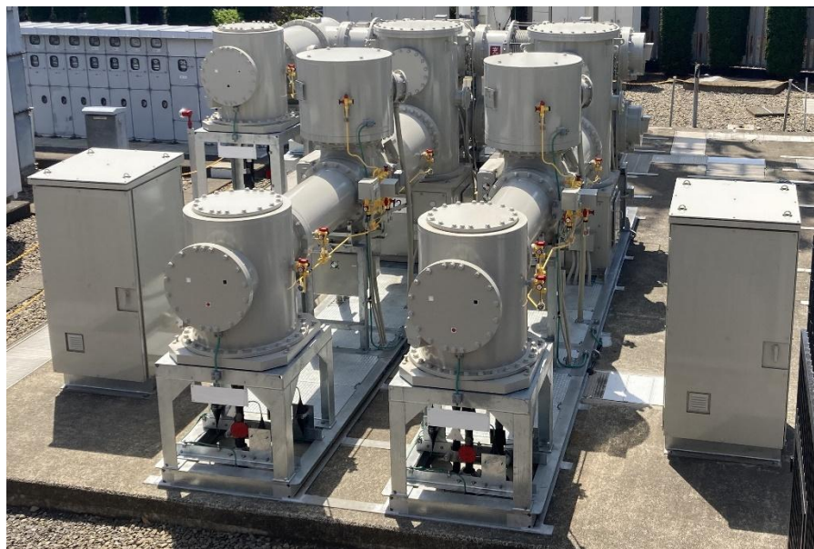
国内電力初のSF 6 ガスを使用しない66kV GIS [府中変電所(東京都府中市)]
