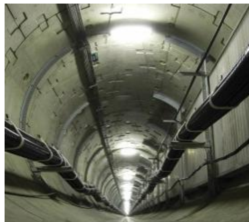
送電設備(地中)
