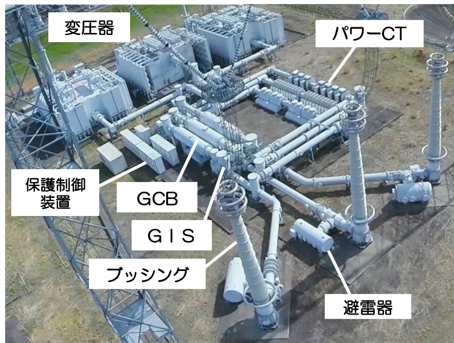
UHV機器試験場 実証試験設備の構成 [新榛名変電所構内(群馬県吾妻郡)]
