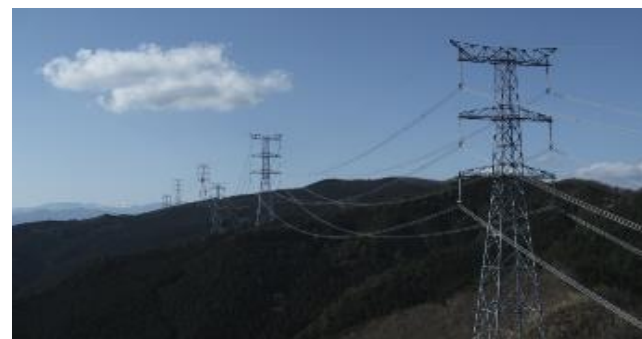
UHV交流送電線
