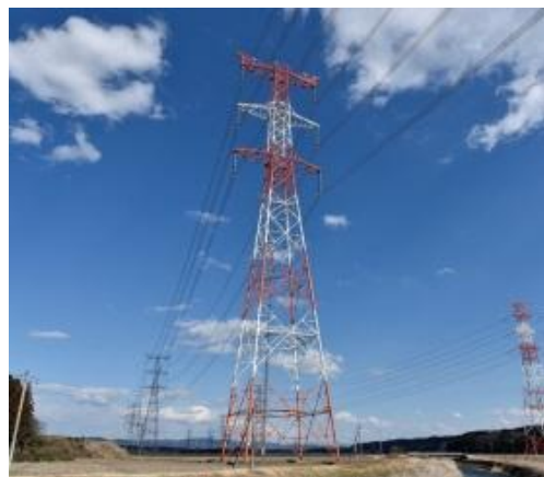
送電設備(架空)
