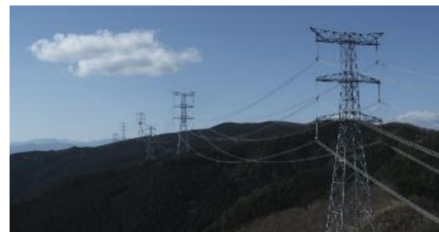
UHV交流送電線
