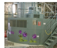
石打発電所(新潟県) 水車発電機台数: 1台
