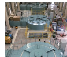
日橋川発電所(福島県) 水車発電機台数: 3台
