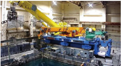
2号機燃料取出装置
