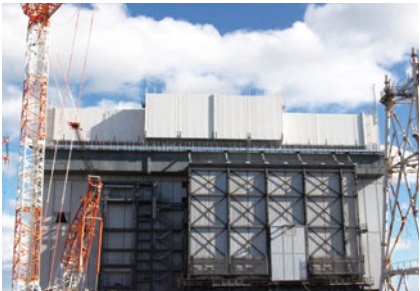
1号機に設置された大型カバー
