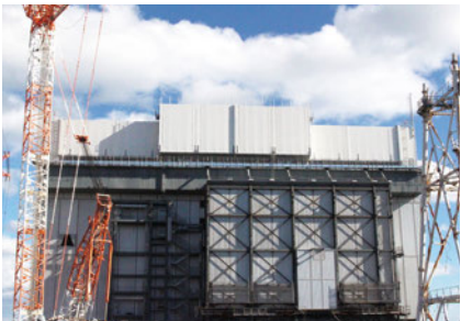
1号機に設置された大型カバー
