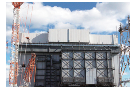
1号機に設置された大型カバー
