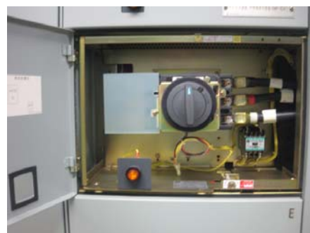
配線用遮断器の例 (MCC)
