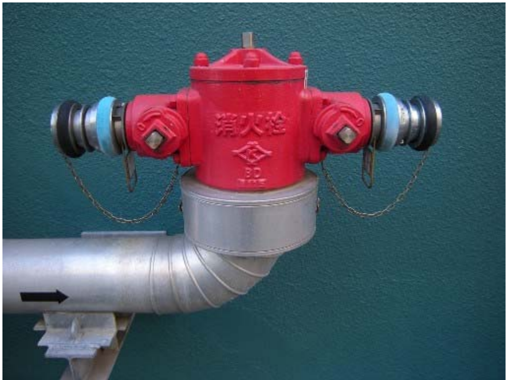
図 1-24 : 不凍式消火栓の設置状況
