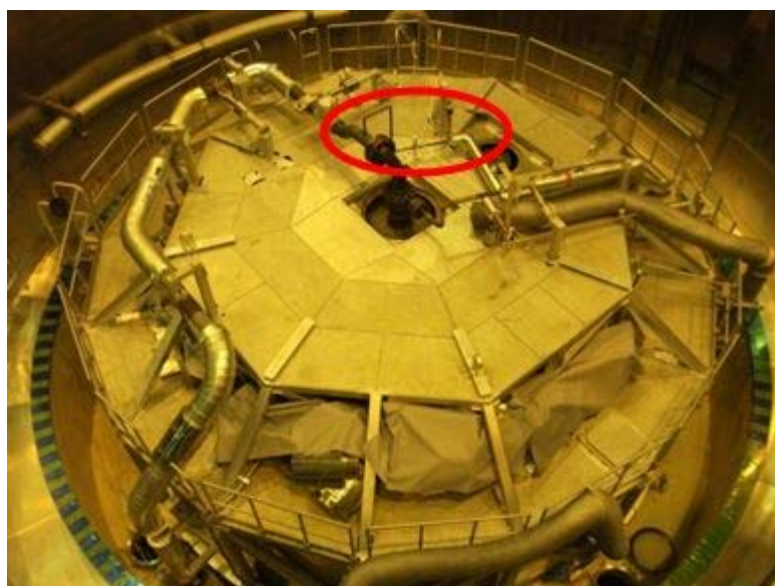
図 1-6：ベント配管の設置例
