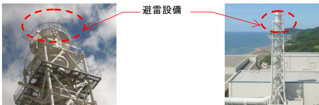
図 1-10：避雷設備の設置例（排気筒）
