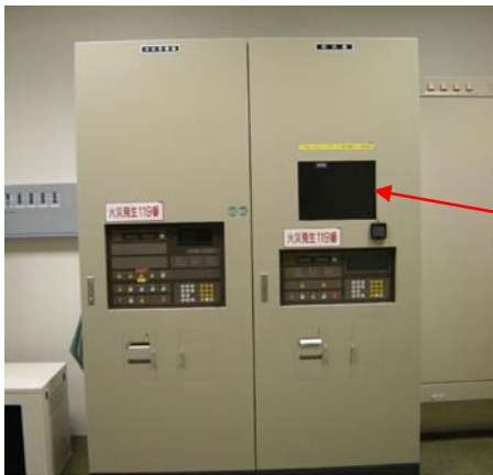
〈火災受信機盤・防災盤〉
