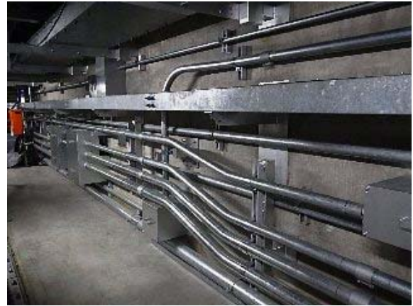
ケーブルトレイ，電線管の例
