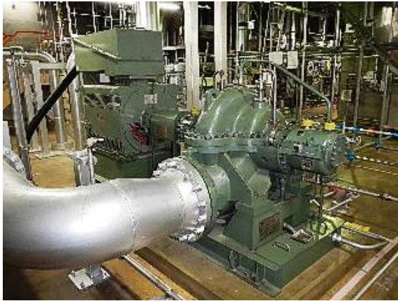
ポンプ，配管，支持構造物の例
