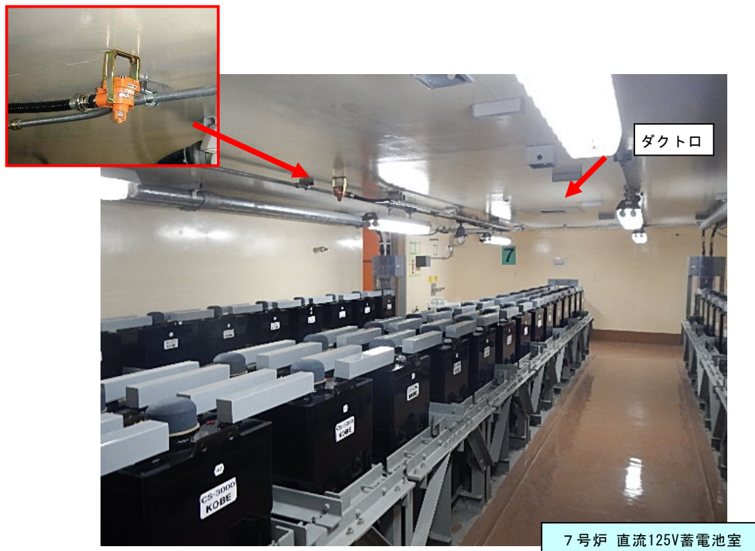
図 1-5 : 蓄電池室内の水素検出器設置状況
