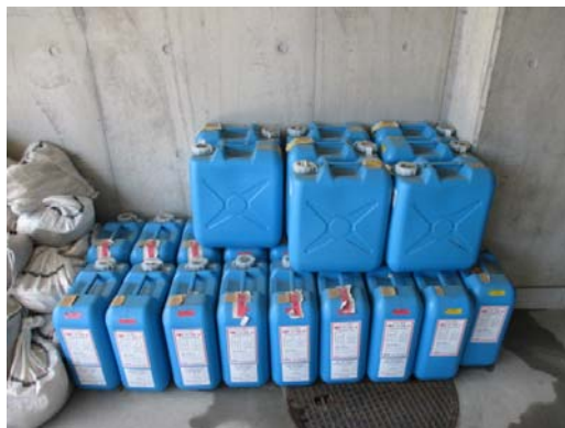
図4 泡消火薬剤ポリタンク 500 リットル
