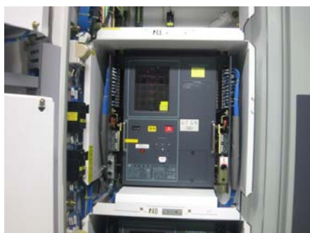
気中遮断器の例 (P/C)
