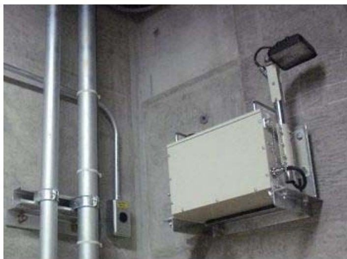
図1-21：消火用非常照明の設置例
