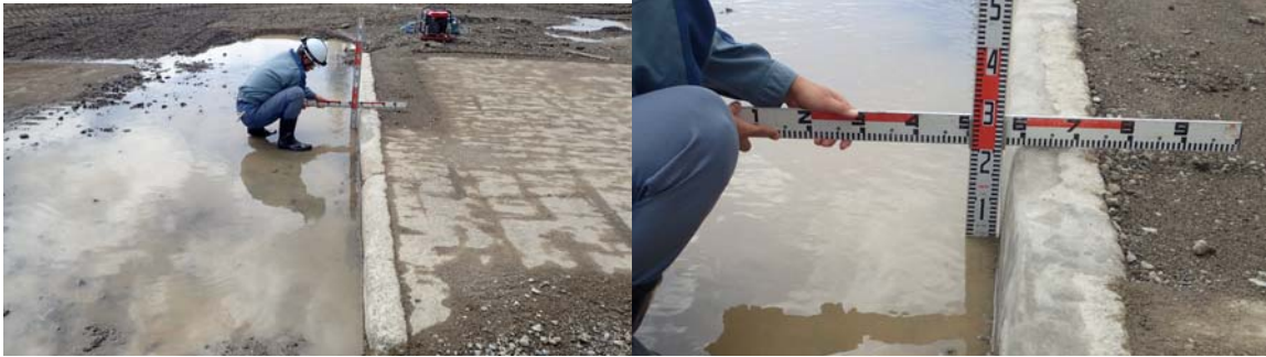
復旧前の段差状況
