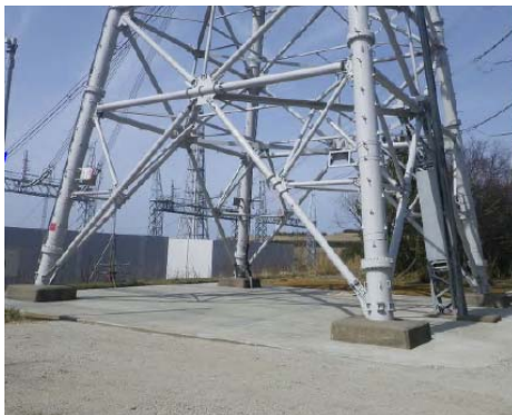
新新潟幹線 No. 1 送電鉄塔
