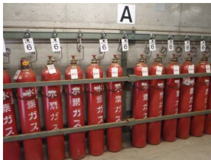
水素ボンベの固縛状況 (6号炉)
