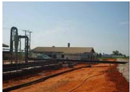
(参考) メタン回収設備
