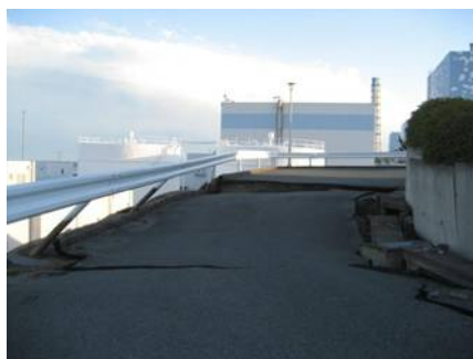
道路の陥没状況
