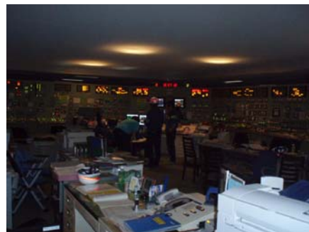
5/6 号中央制御室：5号機側 (非常灯のみ点灯している状態)
