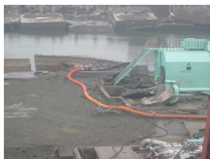
水中ポンプの設置状況 (配置は後日のもの)
