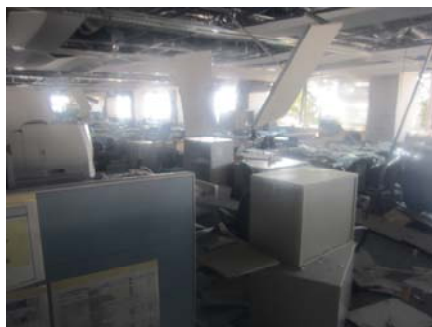
事務本館の被災状況
