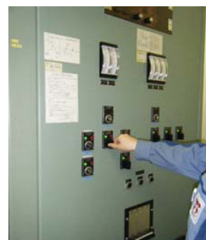
中央制御室AM盤での 弁操作 (作業状況は後日のもの)
