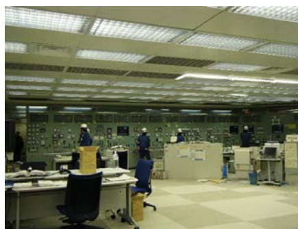
津波到達後の中央制御室
