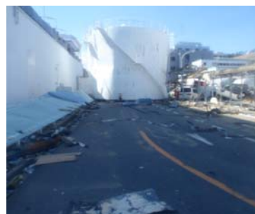
津波で流されたタンク
