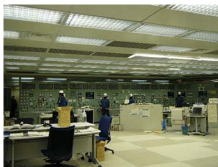
津波到達後の中央制御室
