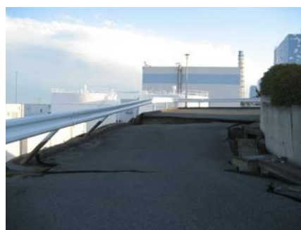
道路の陥没状況
