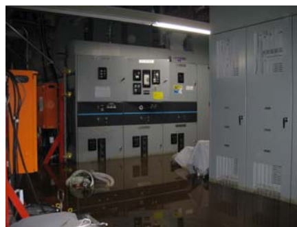
6号機電気品室の浸水状況
