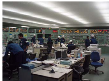
5/6 号中央制御室：6号機側
