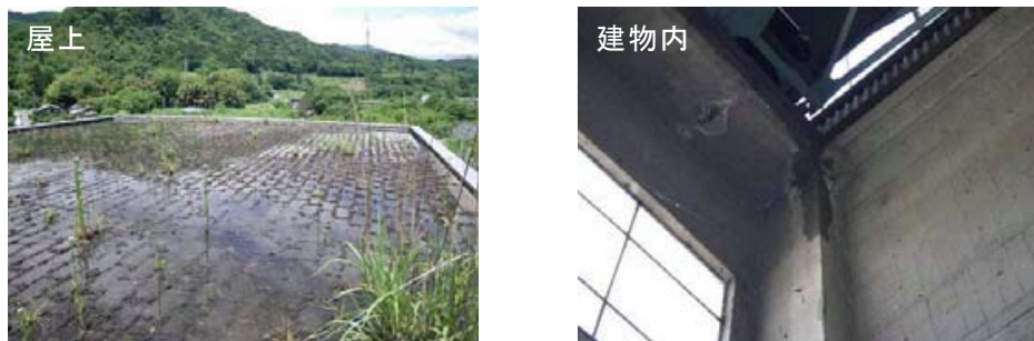
建物雨漏り例
