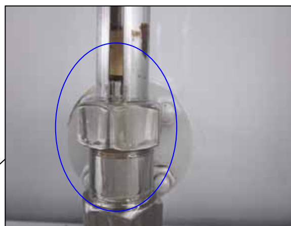
中央接続部漏えい箇所 (NO. 4タンク)
