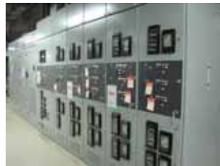
本設復旧された電源盤
