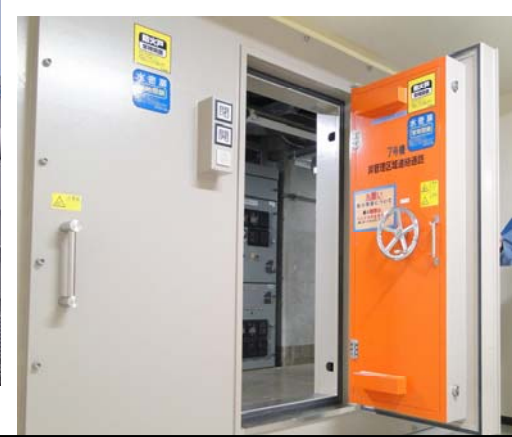
水密扉：重要機器室への浸水を防止(約60箇所)
