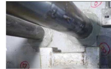
2号機放射性流体ダクト建屋貫通配管
