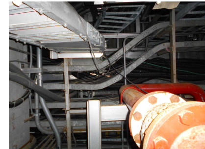
写真1：津波流入が想定される 1R-1'壇上部の状況
