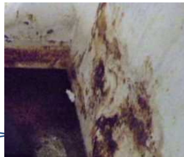
容器内面・補修箇所の状況
