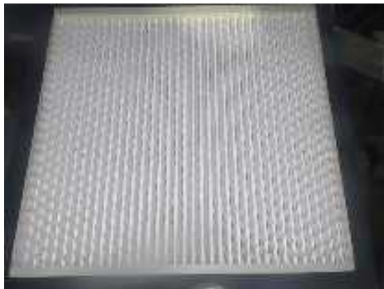
移替え元排気フィルタ（2段目）
