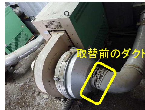
取替前のダクト 吸気ダクト
