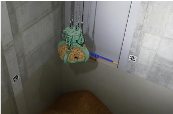
運転中のクレーンの様子
