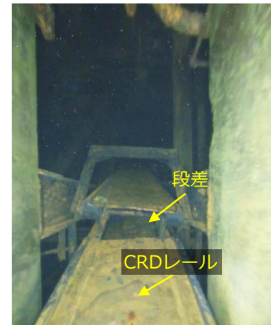
④：CRDレールの段差箇所
