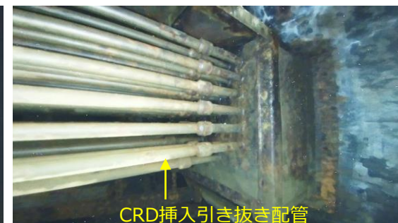
③：CRD挿入引き抜き配管(北西)
