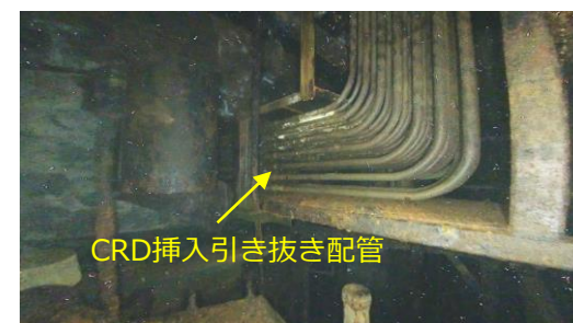
③：CRD挿入引き抜き配管(南西)
