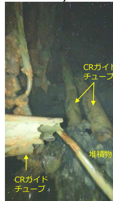
②：落下している構造物
