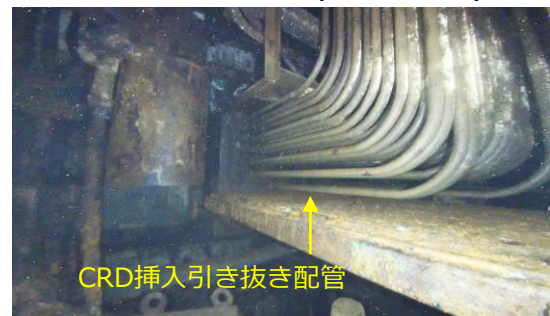
②：CRD挿入引き抜き配管(北東)
