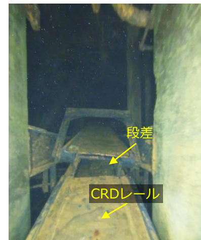
④ : CRDレールの段差箇所
