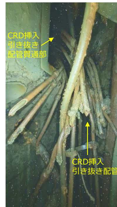
③：CRD挿入引き抜き配管(南東)
