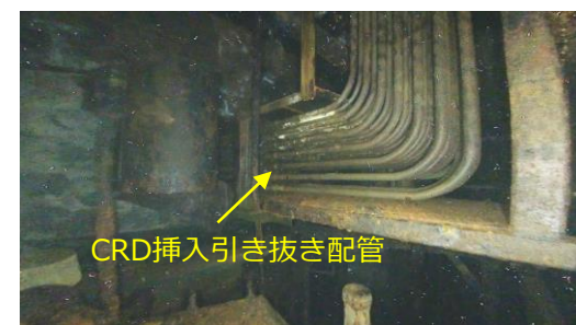
③：CRD挿入引き抜き配管(南西)
