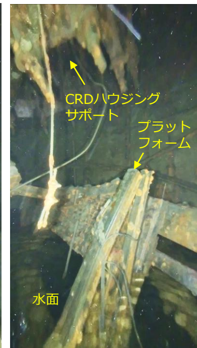
③：CRD交換機関連設備（プラットフォーム）
