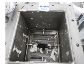
今回損傷が確認されたフィルタ
