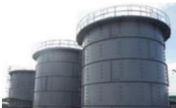
フランジ型タンク
