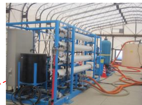
淡水化装置（RO装置）
