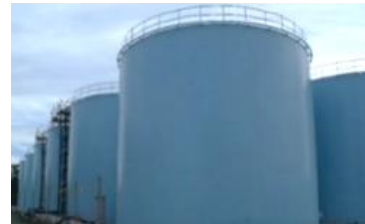
溶接型タンク
