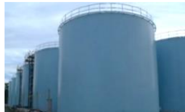
溶接型タンク
