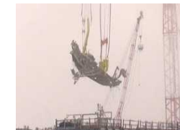
燃料交換機吊り上げ(全景)
