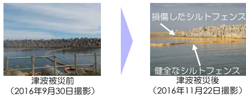
<2-1. 福島第一港湾内シルトフェンスの損傷状況>
