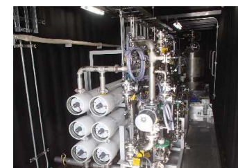
<3-4. 前処理装置設置状況>
