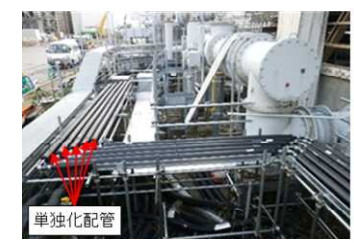
<3-5. 共有配管単独化状況>
