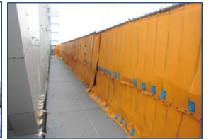
②東側からの線量が高かったため、2m程度の仮設遮へいを設置。
