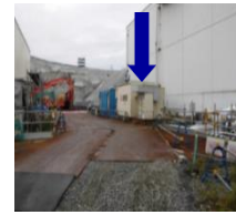
3号機ヤード近くに、線量の低い休憩所を設置（休憩所内線量～0.01mSv/h）
