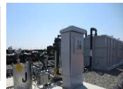
地下水バイパス揚水井
