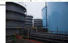
フロンジタンク、溶接タンク
