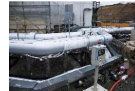
陸側遮水壁ブライン（冷媒）循環配管
