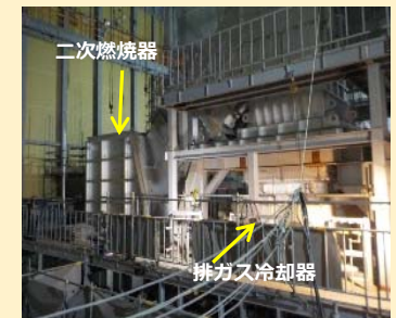
主要機器 (Main equipment)
