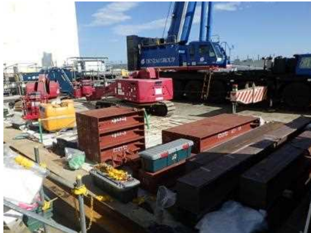
震災時に設置されていたクレーン移動完了 (クレーン移動前の設置個所をフェーシング中)
