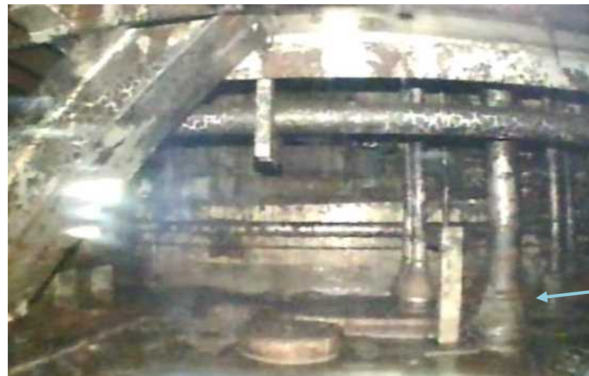
T.P.-0.8m（床面）~T.P.+1m付近：床面に水溜りやにじんでいる状況無
