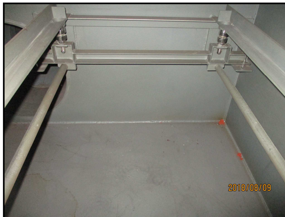
排ガスフィルター（B）内部写真
