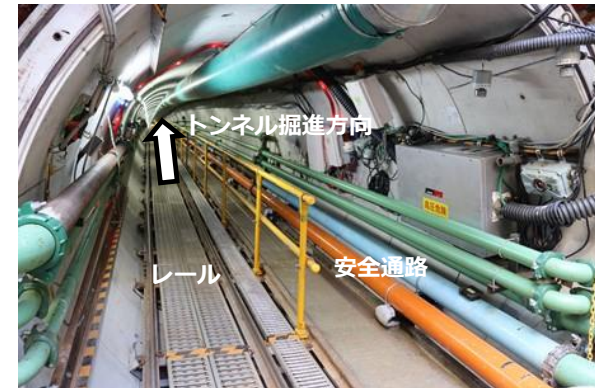
トンネル内部安全設備の整備状況
