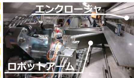
インクロージャ及びロボットアーム
