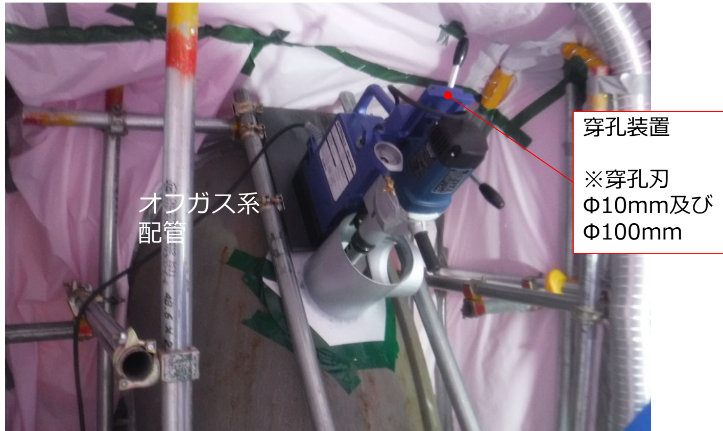
オフガス系配管の穿孔装置設置状況（1/2号機排気筒内部調査時）
