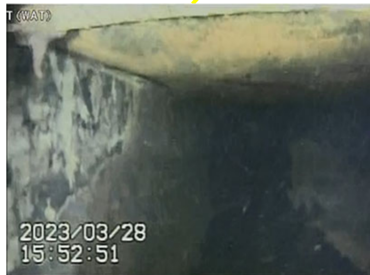
写真3 開口部内部の左側の壁の状態
