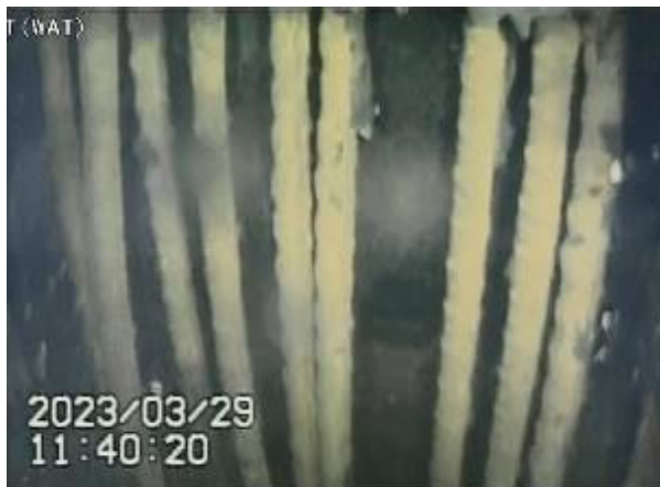
写真2. ポイント⑪下部
