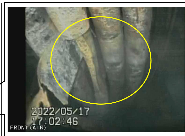
写真2. D/W内配管の状況
