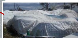
ガレキ (シート養生)
