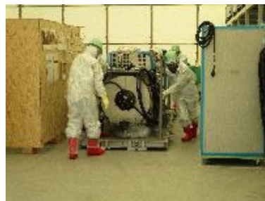
堆積物除去装置 (高圧水、AWJ) 設置
