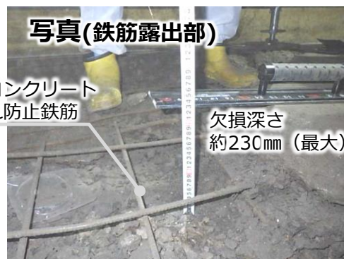
ピット南西側で増し打ちコンクリートが損傷し、ひび割れ防止鉄筋が露出
