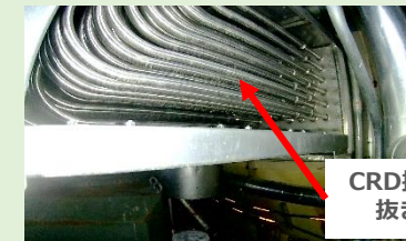
④ CRD挿入引き抜き配管(南)
