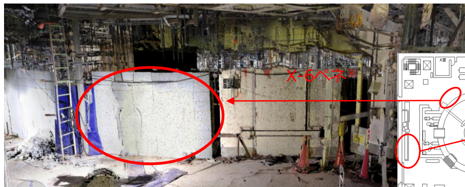
ジェットポンプ計装ラック（R/B 1階北西）
