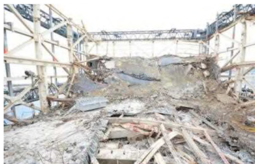
南側崩落屋根の状況
