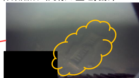
干渉物の例（落下したダクト） ※移動済
