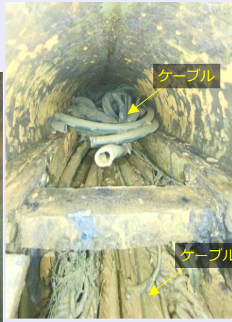
X-6ペネ内部 (PCV内より撮影)
