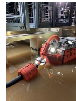
ホースが浮き、水平方向へ伸びている状態 (正常時)
