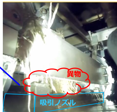
吸引ノズルに付着した異物 (土嚢袋の破片と想定)
