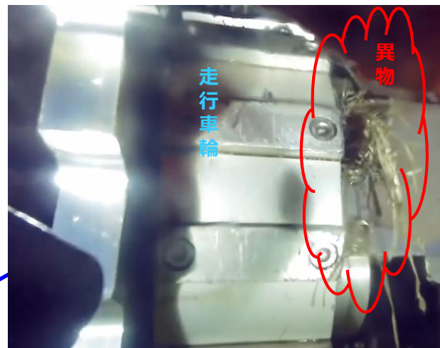
走行車輪 (ホイール) の隙間に付着した異物 (土嚢袋の破片と想定)
